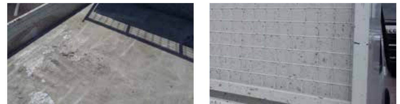
Spuren von Beton oder chemischen Produkten, die \geq ¼ der Oberfläche des Trichters bedecken
