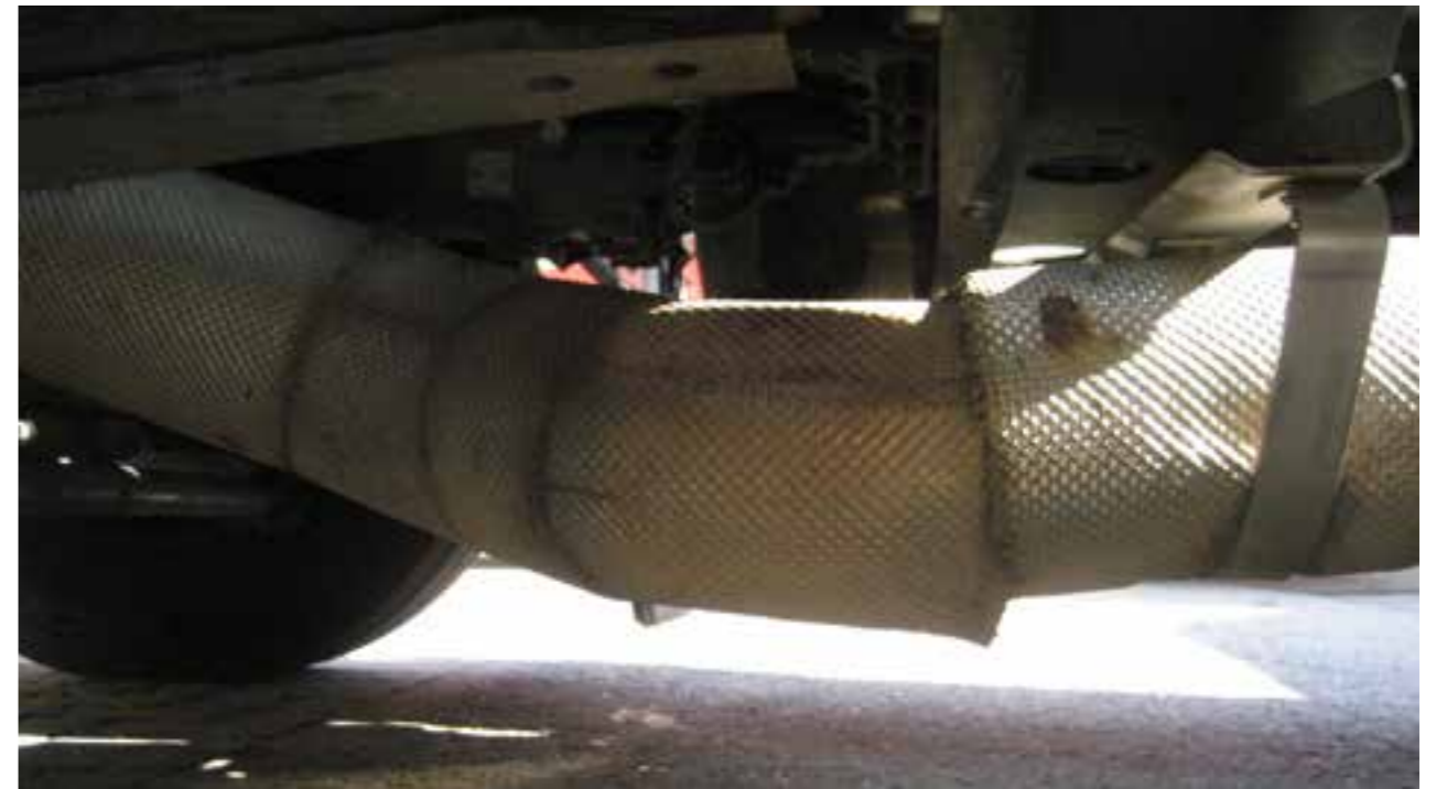
Folgendes wird nicht akzeptiert: gebrochene Rohre, gerissene Wärmedämmung, Kratzer die tief im Material sitzen sowie Dellen, die den Rohrdurchmesser verringern.
